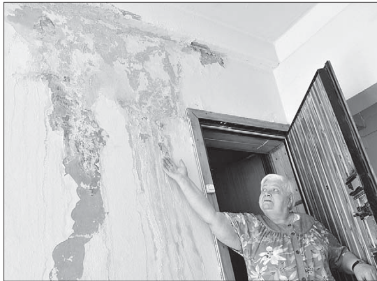
Уже 9 лет блокаднице обещают сделать ремонт и устранить следы протечек
