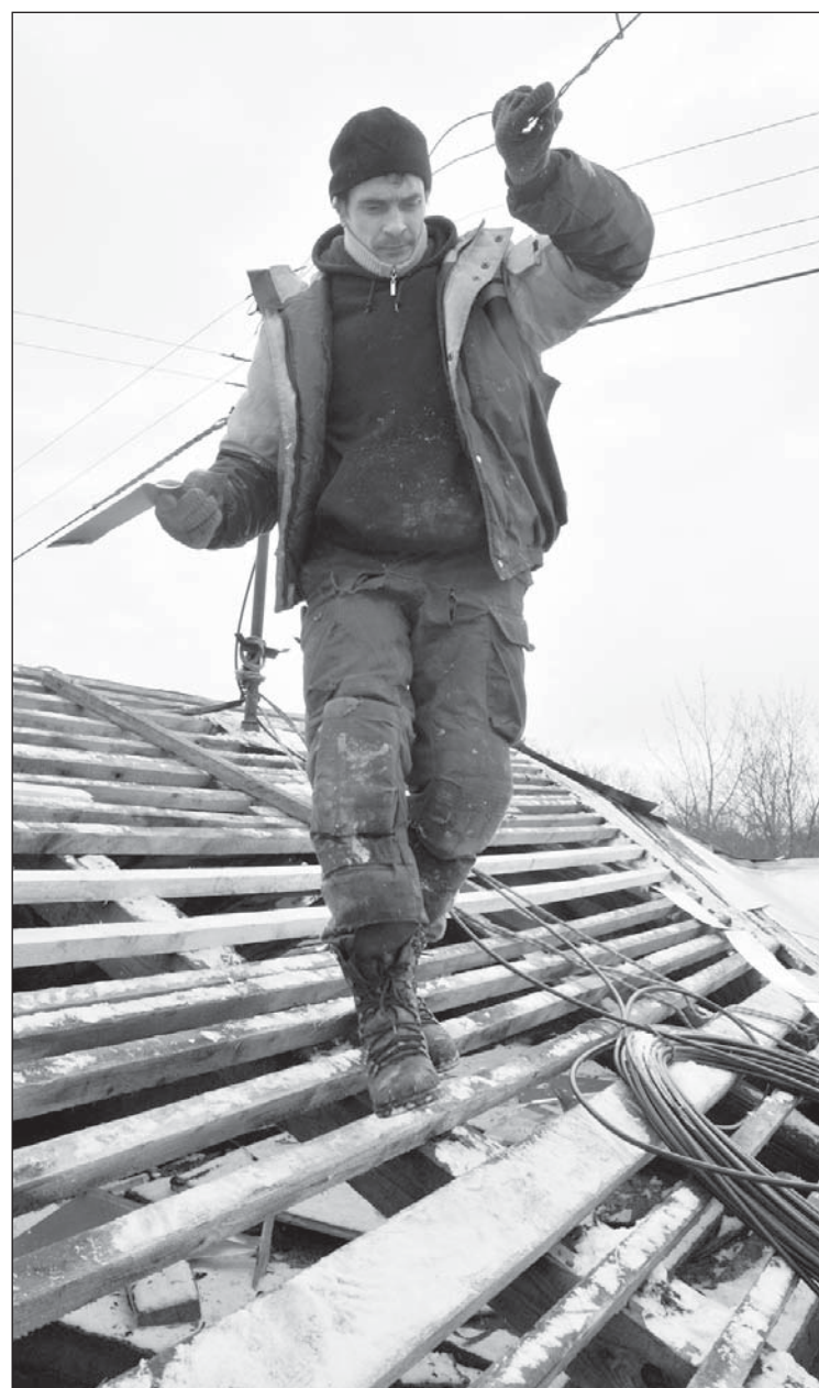
От скольжения кровельщика защищают специальные ботинки, от ветра - непродуваемая куртка, но самое главное - не потерять равновесие, ведь наши мастера работают без всякой страховки
