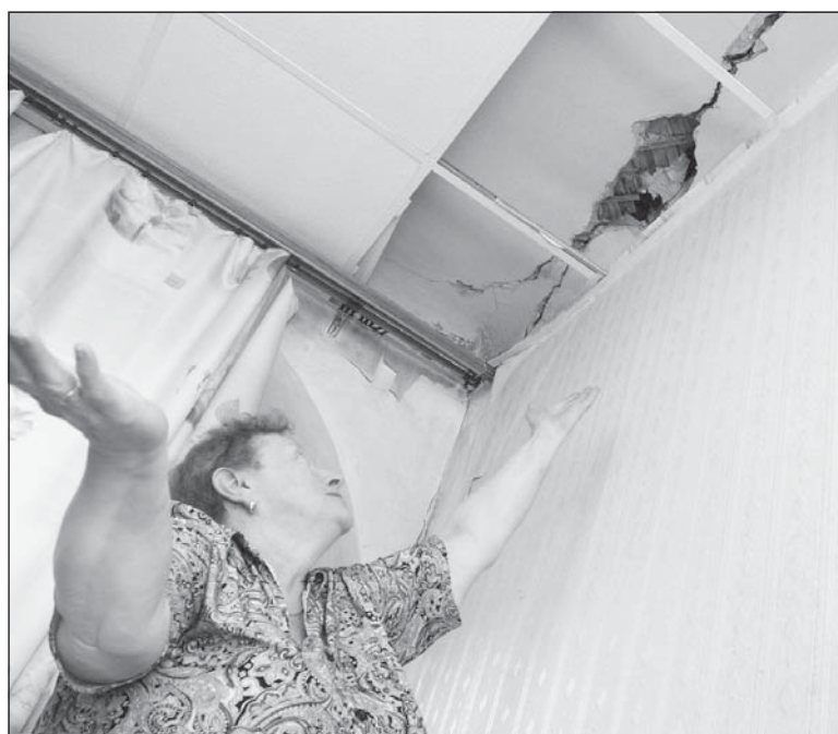
Ольга Андреева считает, что трещина возникла из-за строительства «Галереи»
