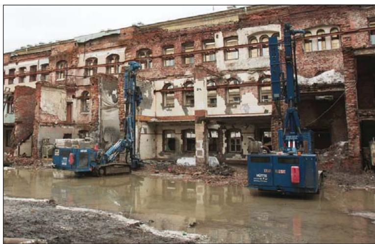
От Пушкарских бань осталась одна фасадная стена
