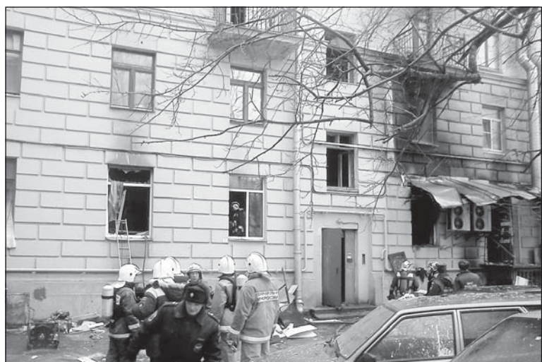
Квартиры, расположенные над рестораном, практически уничтожены
