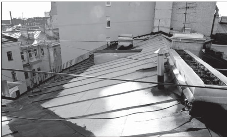
Может быть, с третьей попытки крышу отремонтируют как следует?
