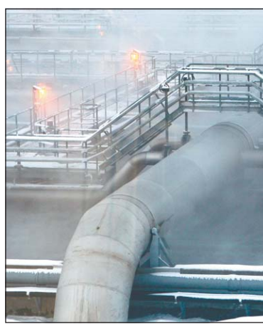
Здесь сжигают осадок от очищенных сточных вод
