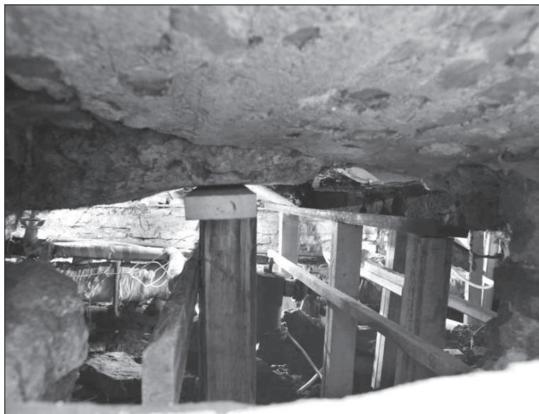
Теперь из квартиры виден подвал
