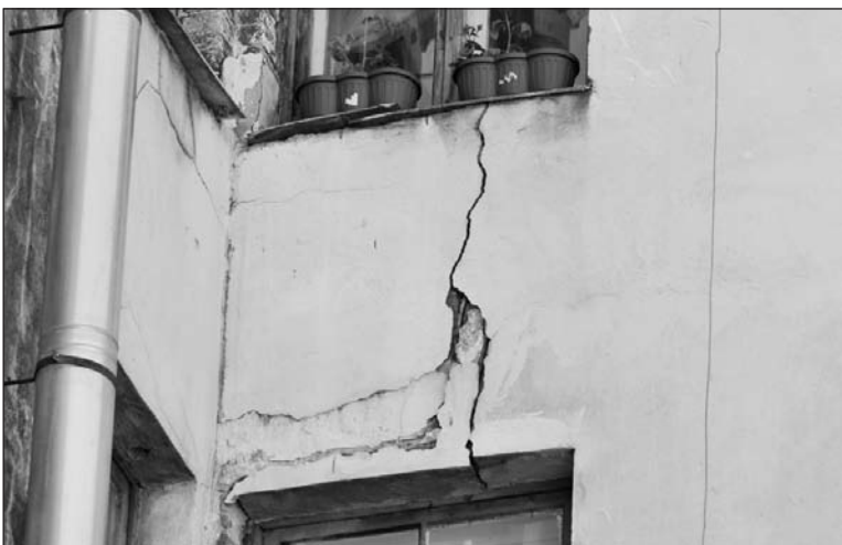
Вот эти трещины уже два года как «взяты на контроль»
